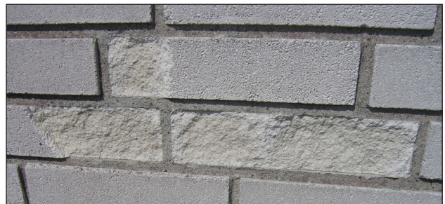
Beskadigede sten udskiftes.
